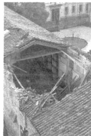
Tetto crollato al teatro Jacquard
